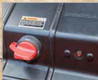
Sezionatore della batteria
