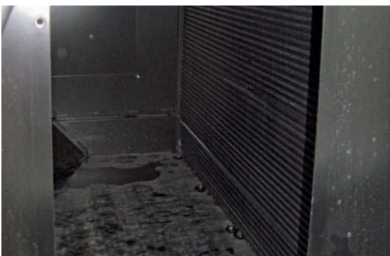
Ottima accessibilità per la pulizia dei radiatori.
