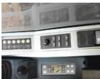
Pannello di controllo centralizzato
