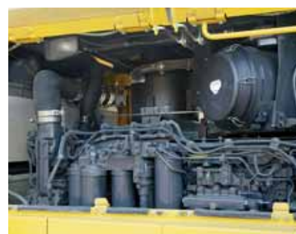
Punti di controllo centralizzati
