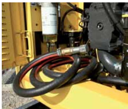
Pompa travaso gasolio
